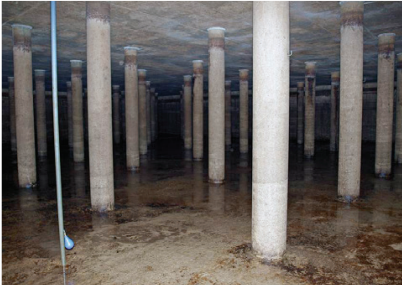
Reinwaterkelder (foto: Oasen.nl)
