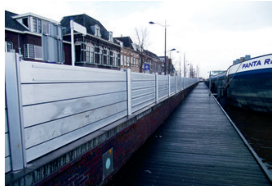
Tijdelijke waterkering langs de rivier Kampen tijdens hoogwater januari 2012 (foto's: Cor van 't Hof)
