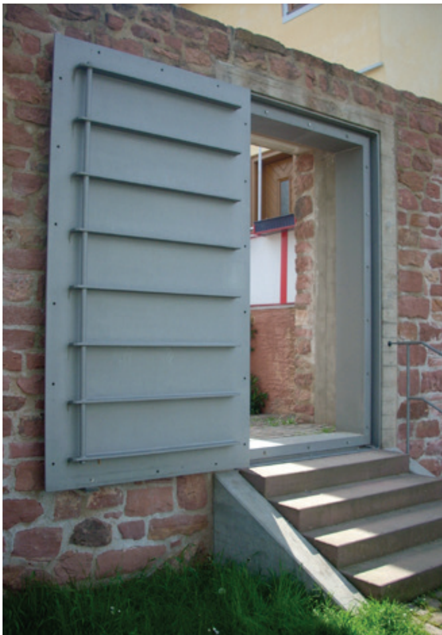
Door middel van waterbestendige deuren en luiken kan het gebouw functioneren als kering (foto: Salino01)
