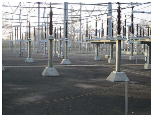
Transformatorstation bij Amersfoort
