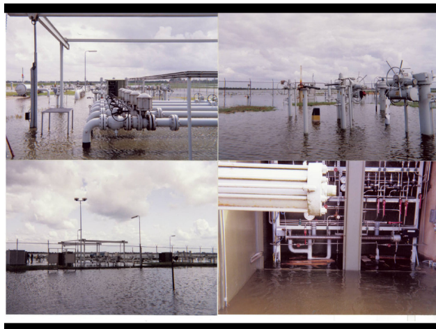
Overstroming van meet- en regelstations
