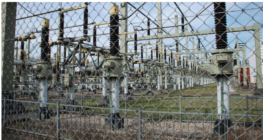
Figuur 12, Schakelstation 150Kv (TenneT)
