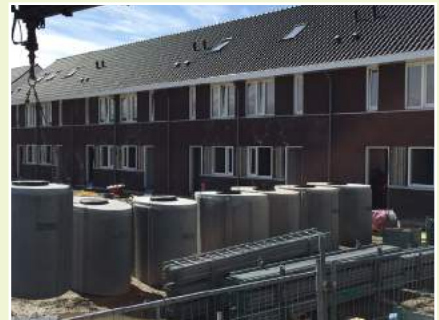
Regenwaterputten bij grootschalige woningbouw met regenwatergebruik
