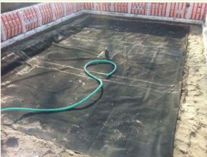
Waterzak als regenwatertank in kruipruimte
