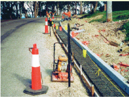
Drainage langs wegen voorkomt aquaplaning en wateroverlast
