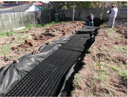
Infiltratievoorziening in een tuin
