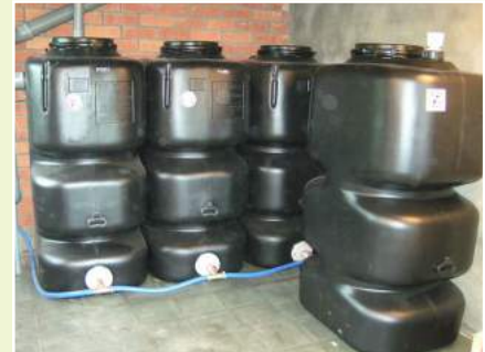
Regenwatertanks in een kelder
