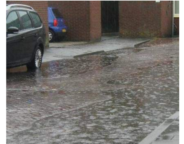
● Water bergen op straat
