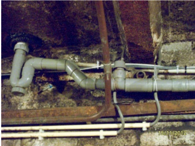
Figuur 17.10 Foutief geplaatste beluchters. Links is de sifon te zien. De beluchter is in het midden geplaatst, dit is echter niet het hoogste punt.
