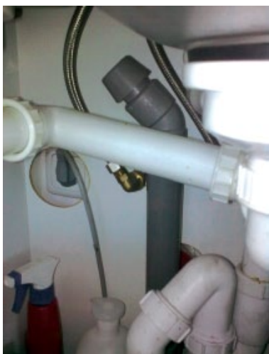
Figuur 17.9 Foutief geplaatste beluchter. Dit is de donker grijze buis; de beluchter is niet verticaal geplaatst en gaat daardoor lekken, met stankoverlast tot gevolg.
