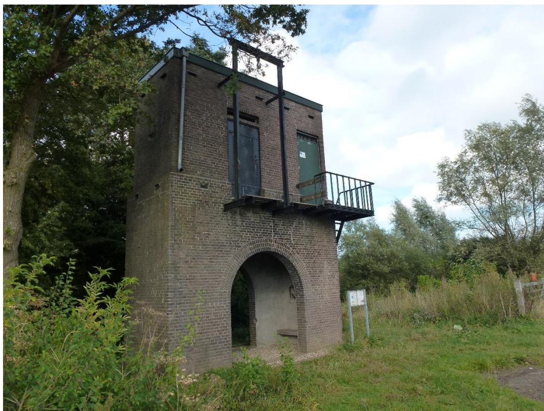
Verhoogd trafohuisje in de Ooijpolder: historisch voorbeeld van gevolgbeperking (bron: Wikipedia Commons / Havang)
