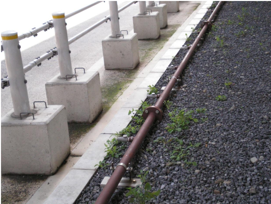
Figuur A7: Sprinklerleiding voor het besproeien van de weg met effluent, Tokyo, Japan (foto: Rutger de Graaf, 2006)
