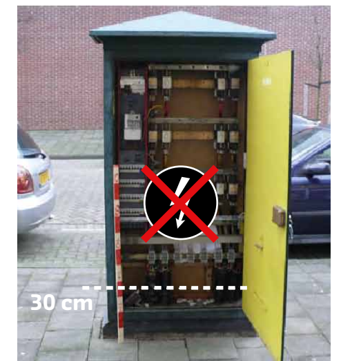
Elektriciteitshuisjes zijn vaak kwetsbaar vanaf 30 cm inundatieniveau op het maaiveld
