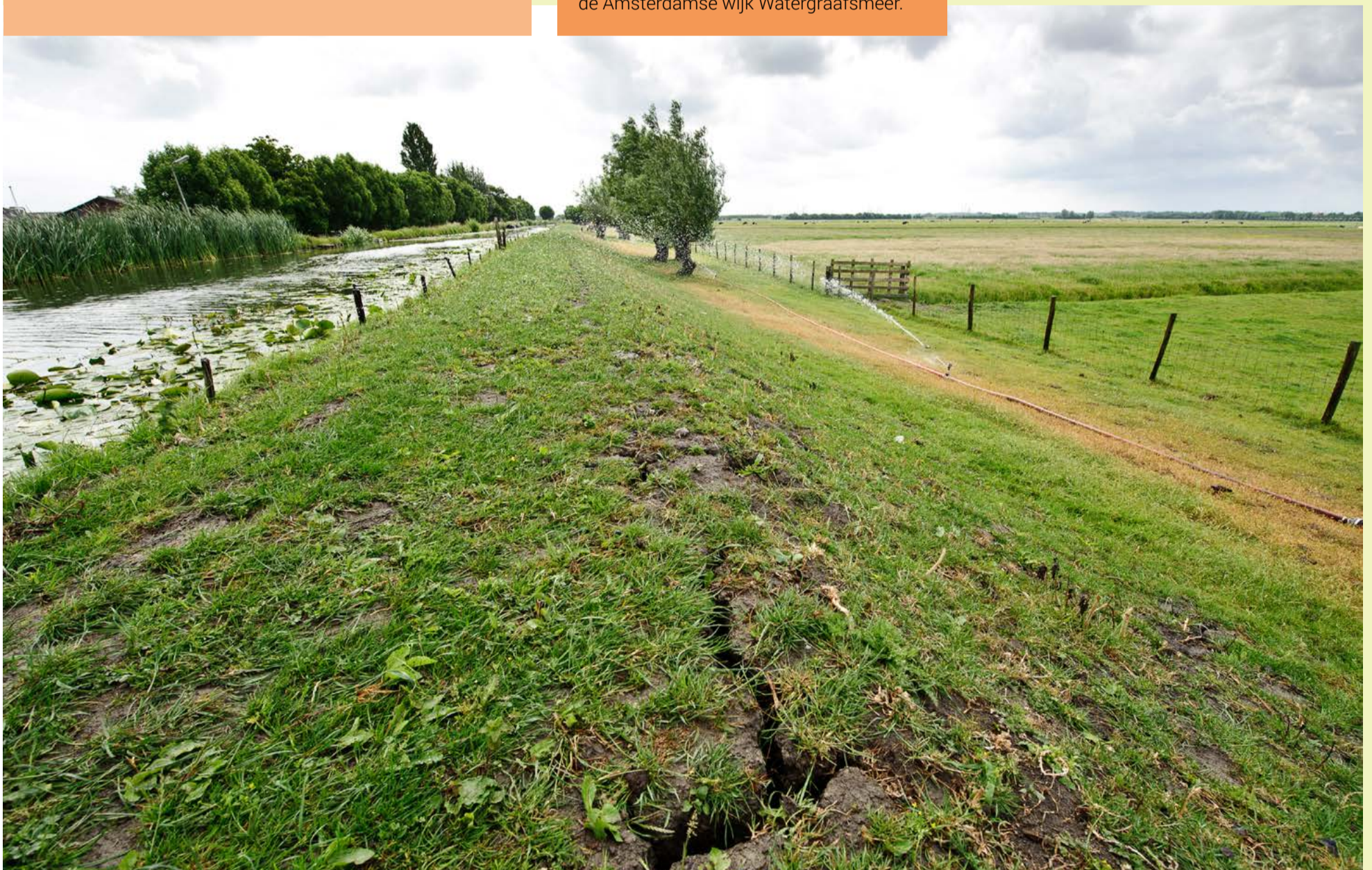
Gescheurde veendijk met sproei-installatie. Preventief besproeien voorkomt het verdrogen van veendijken. Dit gebeurde in 2011 onder meer in Maasland (Zuid-Holland).
