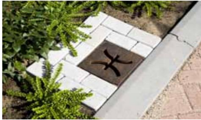
Figuur 31 Exfiltratiekolk naast verharding (Samen regenwater)
