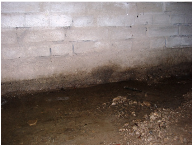
Grondwater in de kruipruimte
