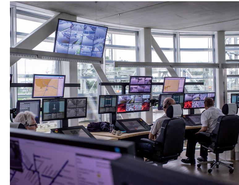
Brugbedieningscentrale Steekterpoort. Hier worden veel bruggen op afstand bediend.
