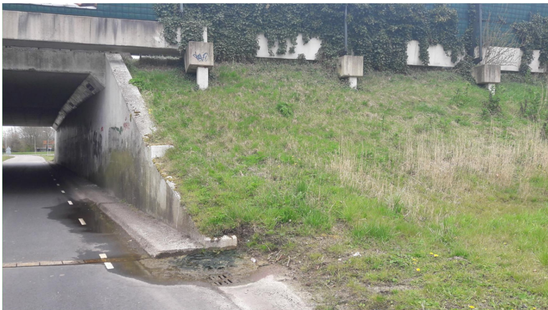
Figuur 5 opkwellend grondwater aan alle 4 de hoeken van dit viaduct, dat op de grens tussen veenweide en polder ligt [foto door Roelof Stuurman (Deltares)]
