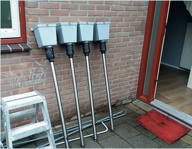
Afvoermeetbuizen met opvangbak. (Foto: Hendrikjan Teekens)
