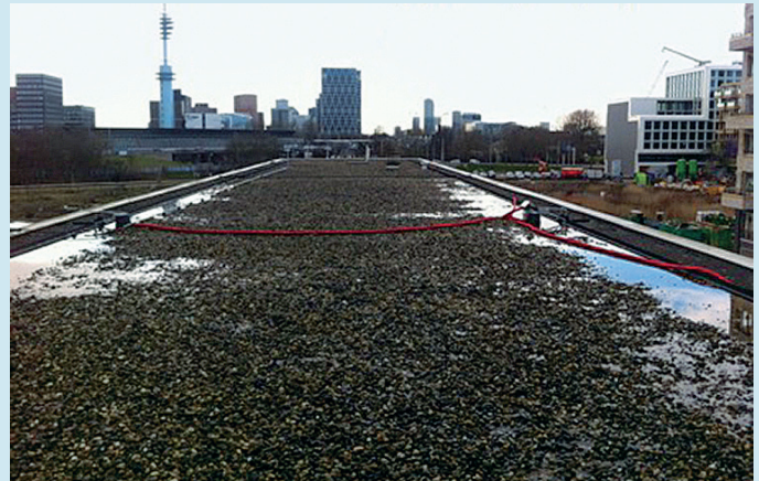
Zwart 'referentiedak' met op de voorgrond een klepgestuurd deel en op de achtergrond een vrij afwaterend deel. (Foto: Rob Tijssen)
