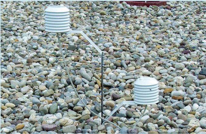
Meetapparatuur op het dak. (Foto: Michiel Rijdsijk)
