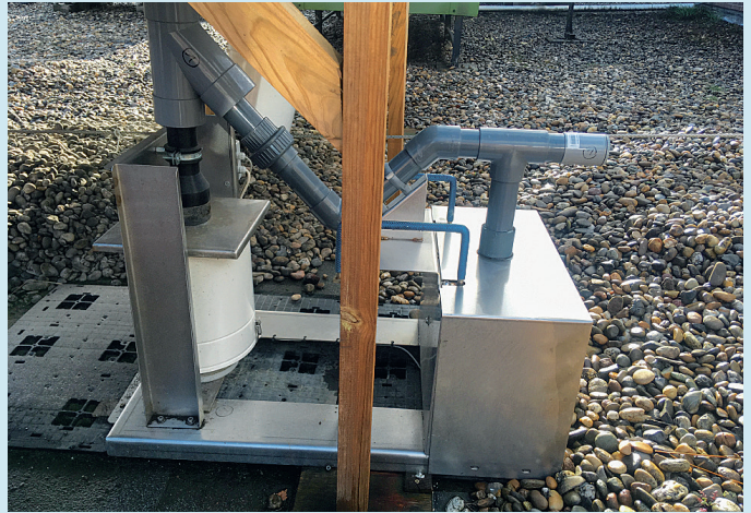
Detail van de opstelling om de afstroming van groendaken te meten met twee pluviometers. (Foto: Vincent Wolfs)
