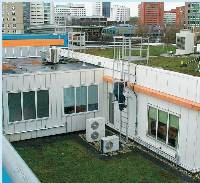
Dak 17, het groene dak met ervoor het zwarte dak tijdens het aanbrengen van de meetapparatuur.
