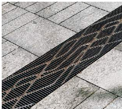
Hoogwaardige verholen afwateringsgoot - Pitt Street Mall - Bron: Tony Caro Architecture
