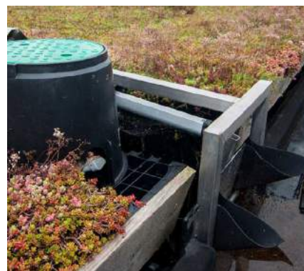
Polderdak met automatisch regelsysteem
