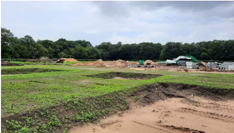
Figuur 1.6: Kunstmatige leeflaag voor groen op zandcunet, nieuwbouwlocatie Zeist. De laagtes vormen ruimte voor funderingen van gebouwen en wegen.
