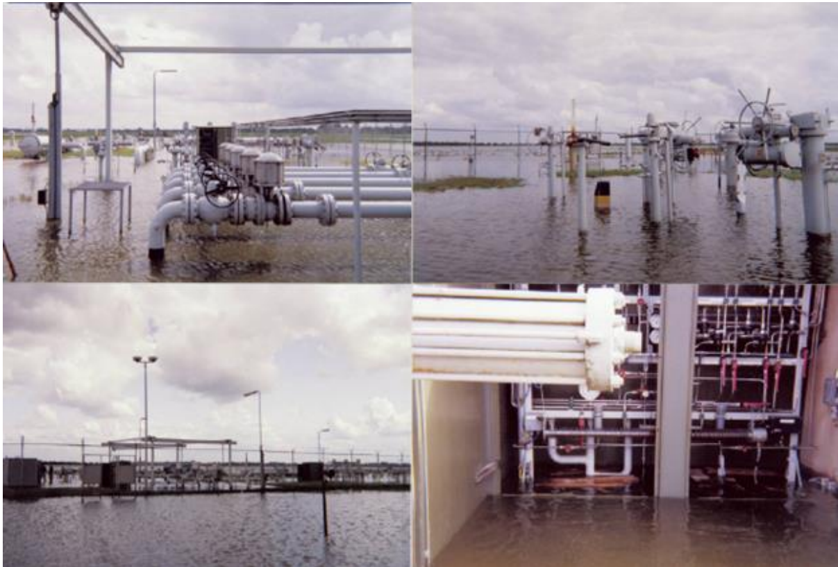
Afbeelding: Overstroming van meet- en regelstations in het gasnetwerk.
