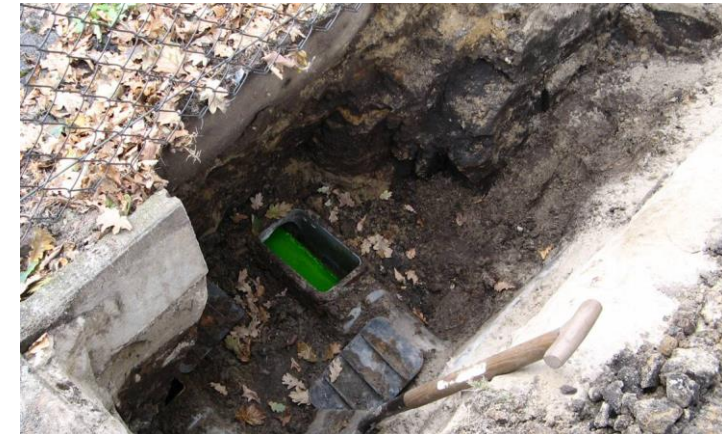
Kleurstofonderzoek foutaansluiting ©Stichting RIONED
