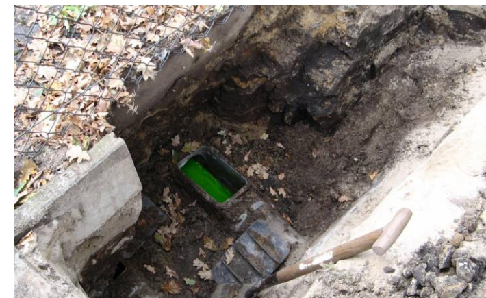
Kleurstofonderzoek foutaansluiting ©Stichting RIONED
