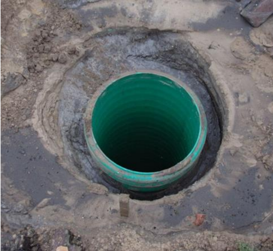
Figuur 20 Diepe grondwaterinfiltratie (bron: Firma Kreeft).
