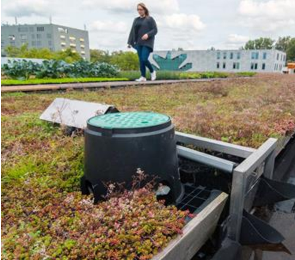
Figuur 3 Foto van het drainagesysteem onder de vegetatielaag (bron: Merlijn Michon Fotografie).
