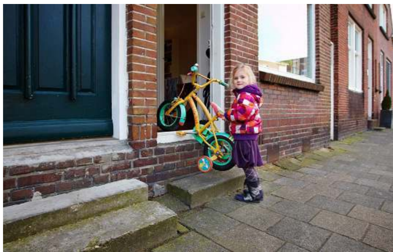
verzakkingen door bodemdaling
