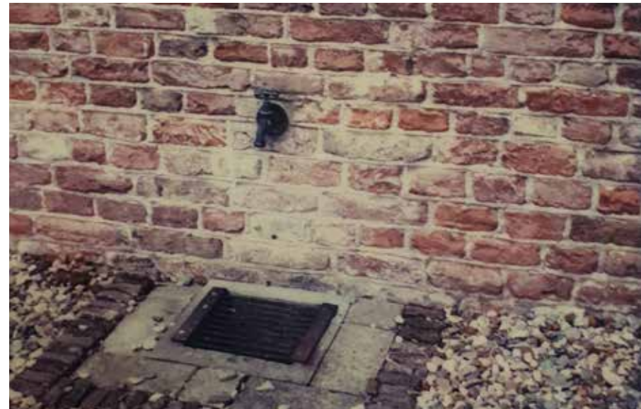
Afb. 69 Kraantje tegen de achtergevel van het huis, vermoedelijk later aanlegd ('80, SMZ).
