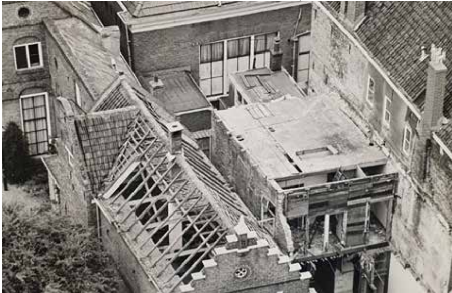
Afb. 45 Sloop van het voormalige koetshuis aan de Voorstraat en Telegraafkantoor. Foto juli 1965 (Archief SMZ).
