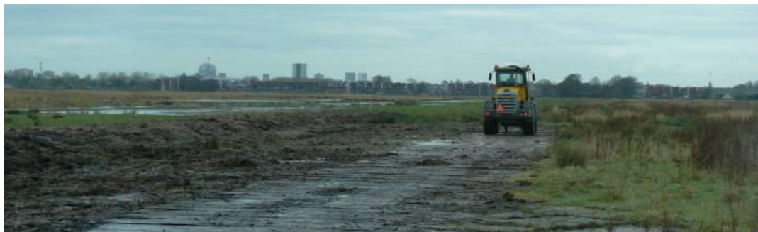
Werkzaamheden aan de Eelder en Peizermaden, met Groningen op de achtergrond (foto Arnold van Kreveld)
